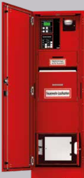
Eintürige Erstanlaufstelle bei- spielhaft ausgebaut gemäß Vorgabe der TAB München
